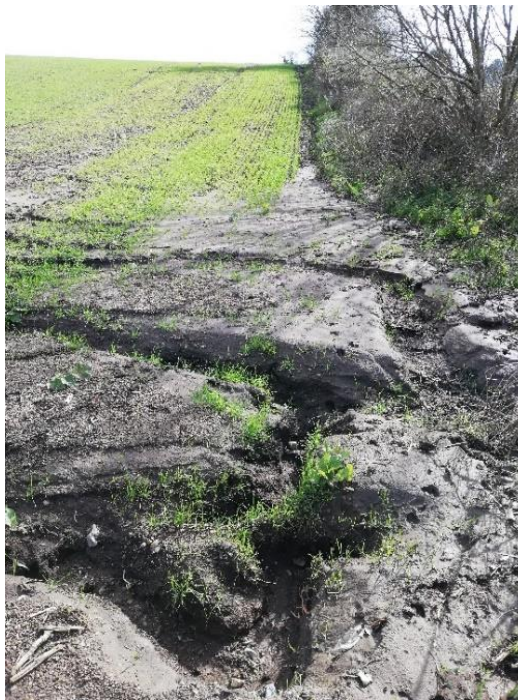
Erosion en bas de la parcelle 60-1, 27/02/2024
